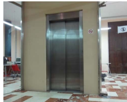
Zona de embarcament ascensor (pl. segona)
