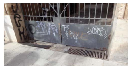
Desnivell i reixa al paviment
