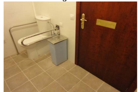
Interior bany adaptat amb barres auxiliars
