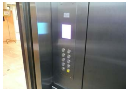
Ascensor edifici Cort
