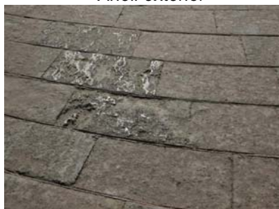
Irregularitats al paviment
