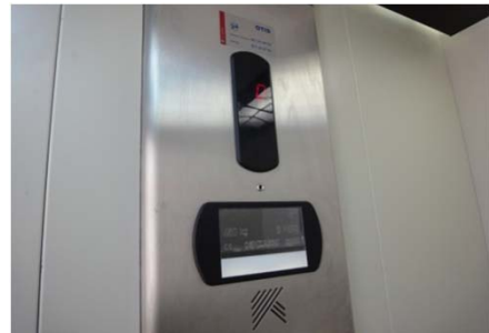
Interior de la cabina de l'ascensor
