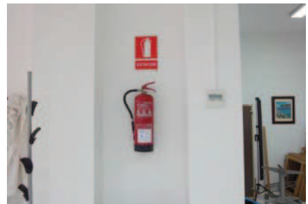
Situació d'extintors i comandaments d'aire acondicionat
